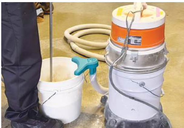
徒弟の世界から組織へと変わり、働く環境も整えられている。一例がこの集塵装置。材料攪拌時の粉塵対策も万全に。
